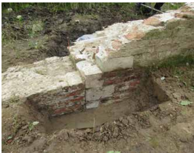
Afb. 8 Gevelhoek van de schildmuur van de voorburcht, met een hoekblokpatroon van Gobertange steen. Op de gevelhoek sluit het metselwerk van de beer aan, die de gracht tussen voor- en hoofdburcht afsloot. Foto: auteur 2017.
