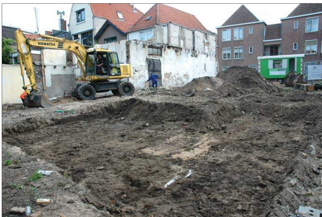
Afbeelding 2: Aanleg van het eerste vlak in werkput 1. Foto is richting oosten genomen.
