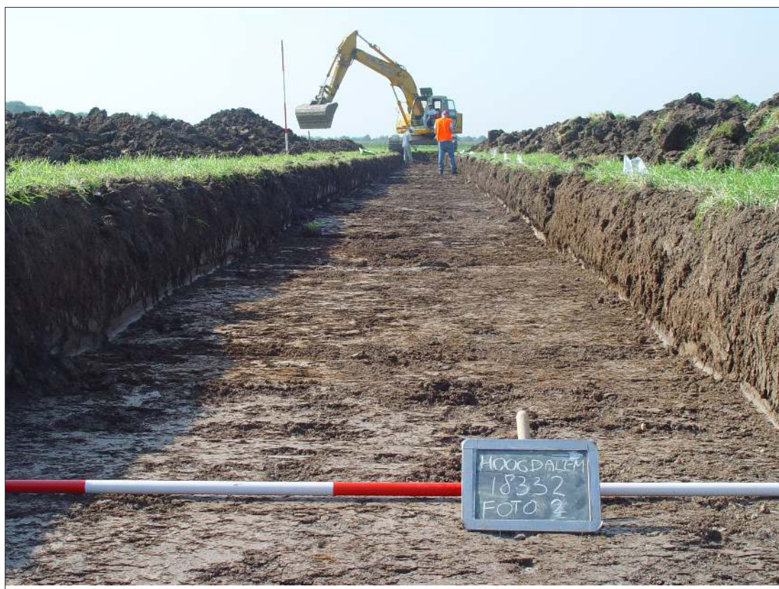
Afb. 3: De aanleg van de eerste proefsleuf. De bouwvoor is apart gehouden van de rest van de uitgegraven grond, om het perceel in zo goed mogelijke staat weer te kunnen opleveren.
