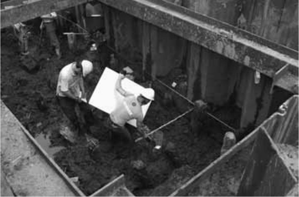
Afb. 9. Amsterdam * Noord-Zuidlijn. De palen van een midden-18de-eeuwse oeverbeschoeiing van de Amstel worden ingemeten (foto: bureau Monumenten en Archeologie, W. Krook).
