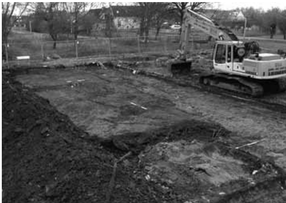
Afb. 37. Delft * Abtswoude 40. Aanleg van het eerste vlak na sloop van de opstallen.
